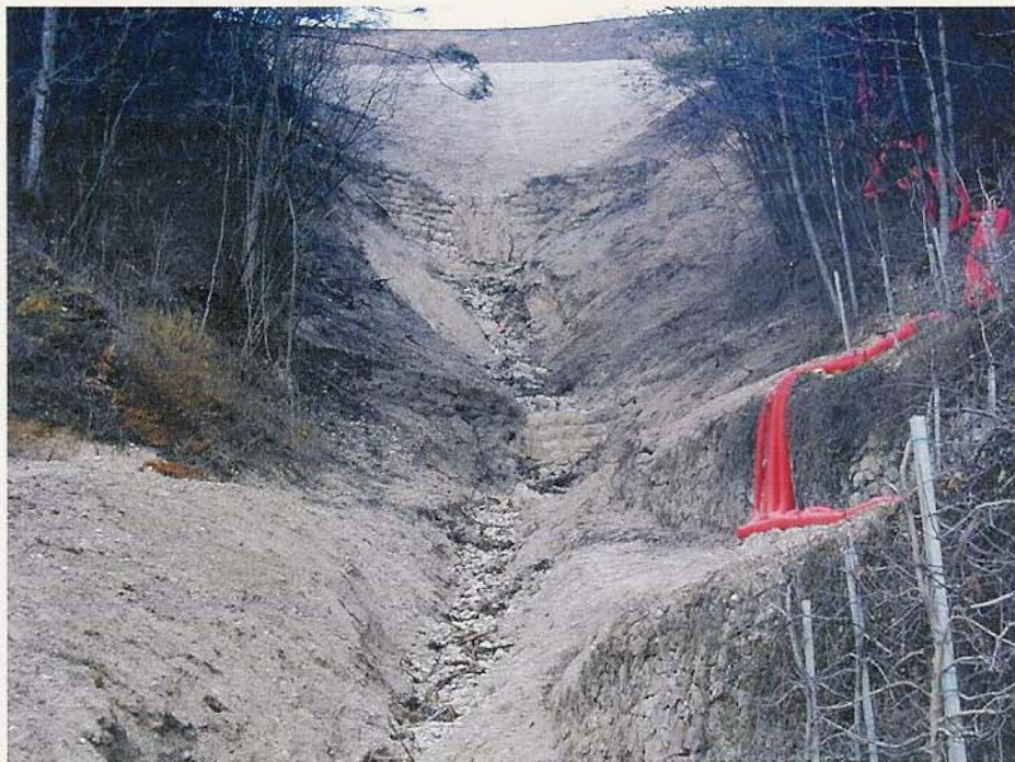
Fig. 10 – Due delle vecchie briglie di consolidamento realizzate nel 1905, messe in luce dalla colata detritica lungo la vallecola del Rio Prà dell'Acqua (dicembre 2000).
