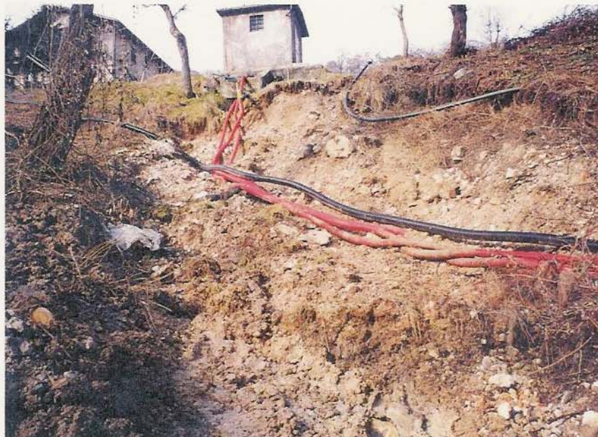
Fig. 8 – Il dissesto presente a valle delle opere di presa in loc. Maso Maset, innescato dalle acque risorgive che sono state allontanate dall'area instabile con tubazioni provvisorie (dicembre 2000).
