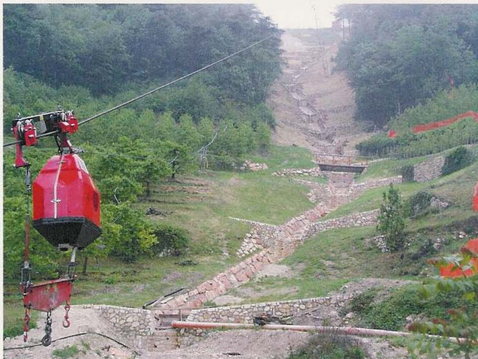
Fig. 11 – Il tratto sul conoide e la parte centro-superiore della vallecola boscata durante i lavori di sistemazione con briglie di consolidamento raccordate da una canaletta in pietrame e calcestruzzo; in primo piano la gru a cavo (teleferica) utilizzata per il trasporto dei materiali (aprile 2002)
