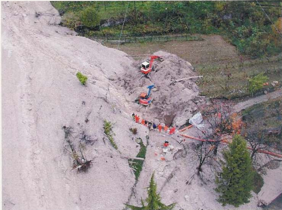
Fig. 6 – L'imbocco della tubazione di by-pass in corrispondenza di via Dos Brun. In primo piano è visibile il materiale ghiaioso depositato sul conoide dalla seconda ondata detritica.
