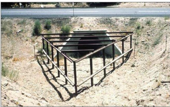
Fig. 18 – Struttura metallica a protezione di tombotti (fonte Bradley et al. 2005)
