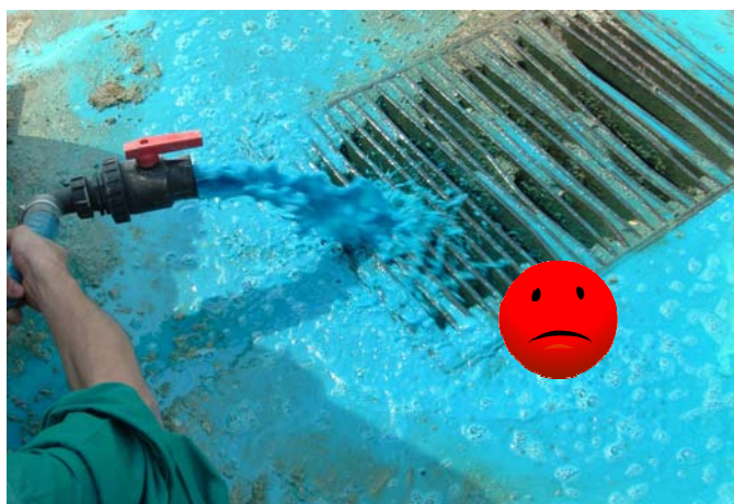
Fig. 100 - Esempio di NON corretto smaltimento della miscela residua e dell'acqua di lavaggio tramite tombino collegato alla rete fognaria.
