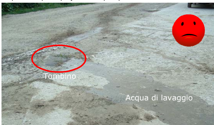
Fig. 99 – Acque di lavaggio immesse direttamente nella rete fognaria.
